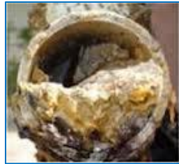
Tubería de alcantarilla obstruida con grasa
